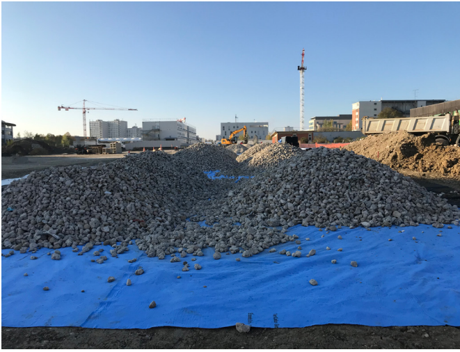
Figure 4: Lestage de l'aquatextile et mise en place de la structure réservoir granulaire
