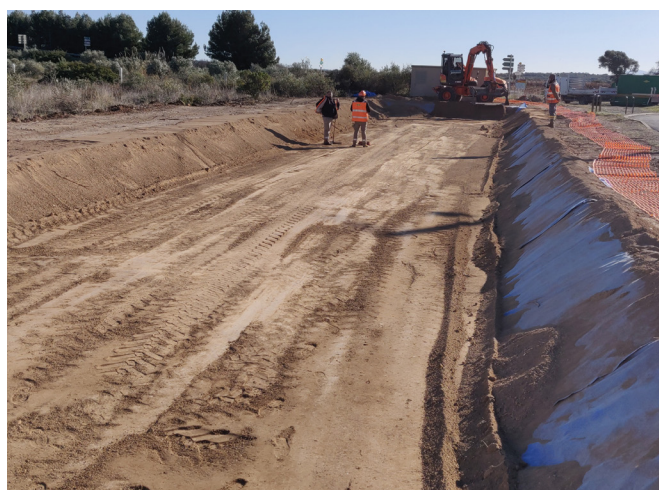
Figure 5: Mise en place du sol de couverture en fond et sur les talus du bassin
